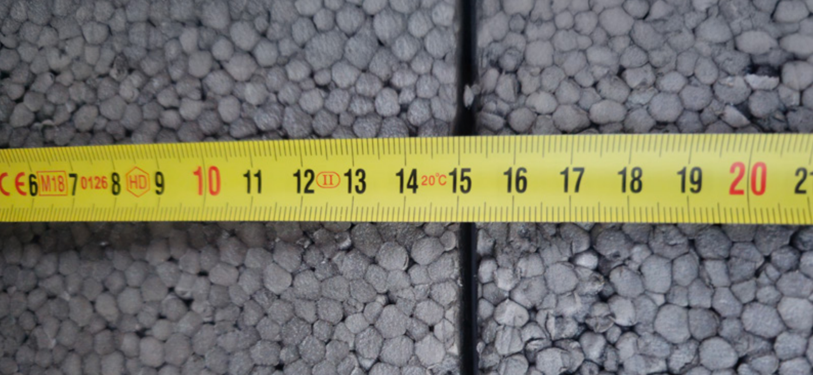
Fot. 6. Niewypełnione szczeliny w spoinach ocieplenia z płyt styropianowych (przykład błędu wykonawczego).
