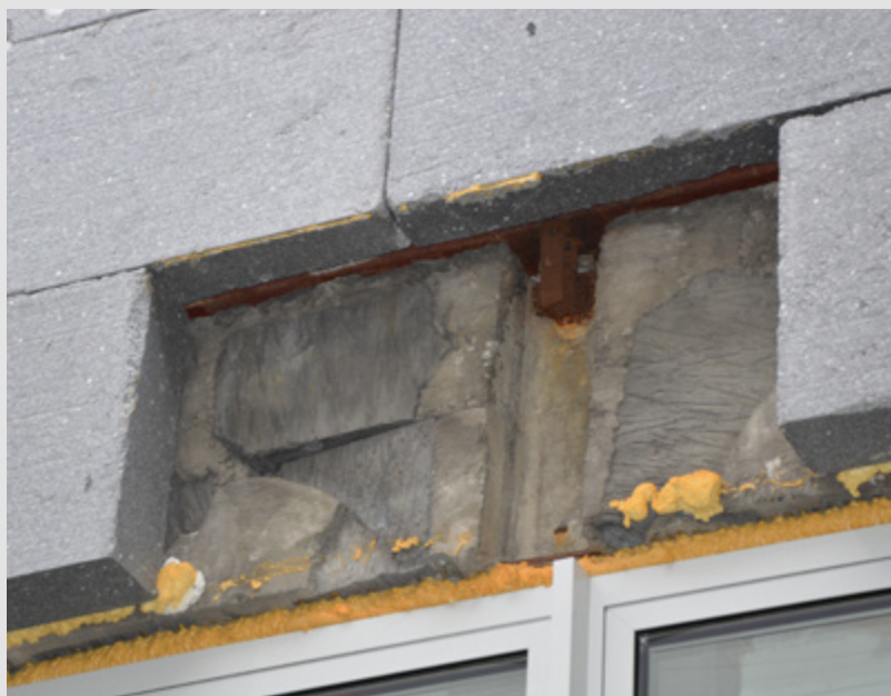
Fot. 5. Nieprawidłowe przygotowanie podłoża.
